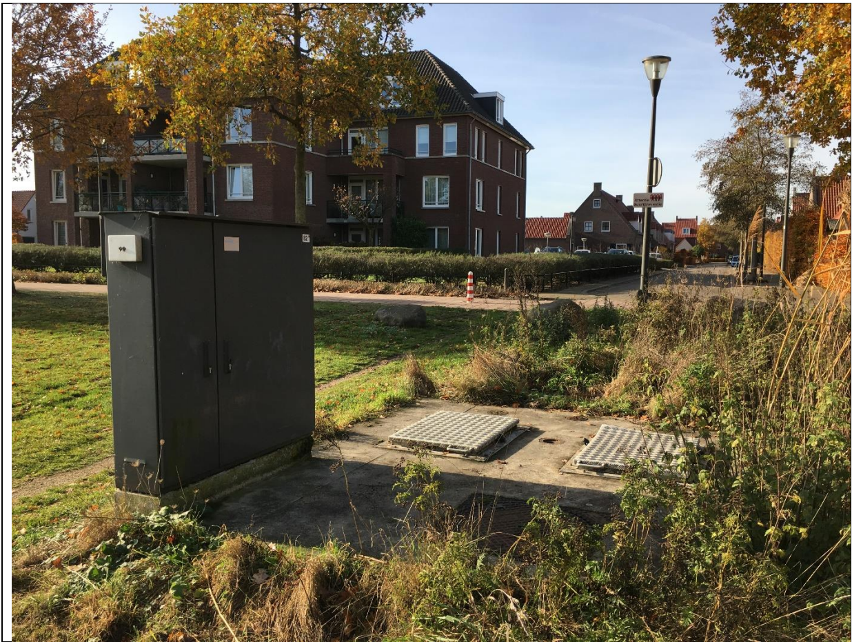
Figuur: Gemaal ecozone
