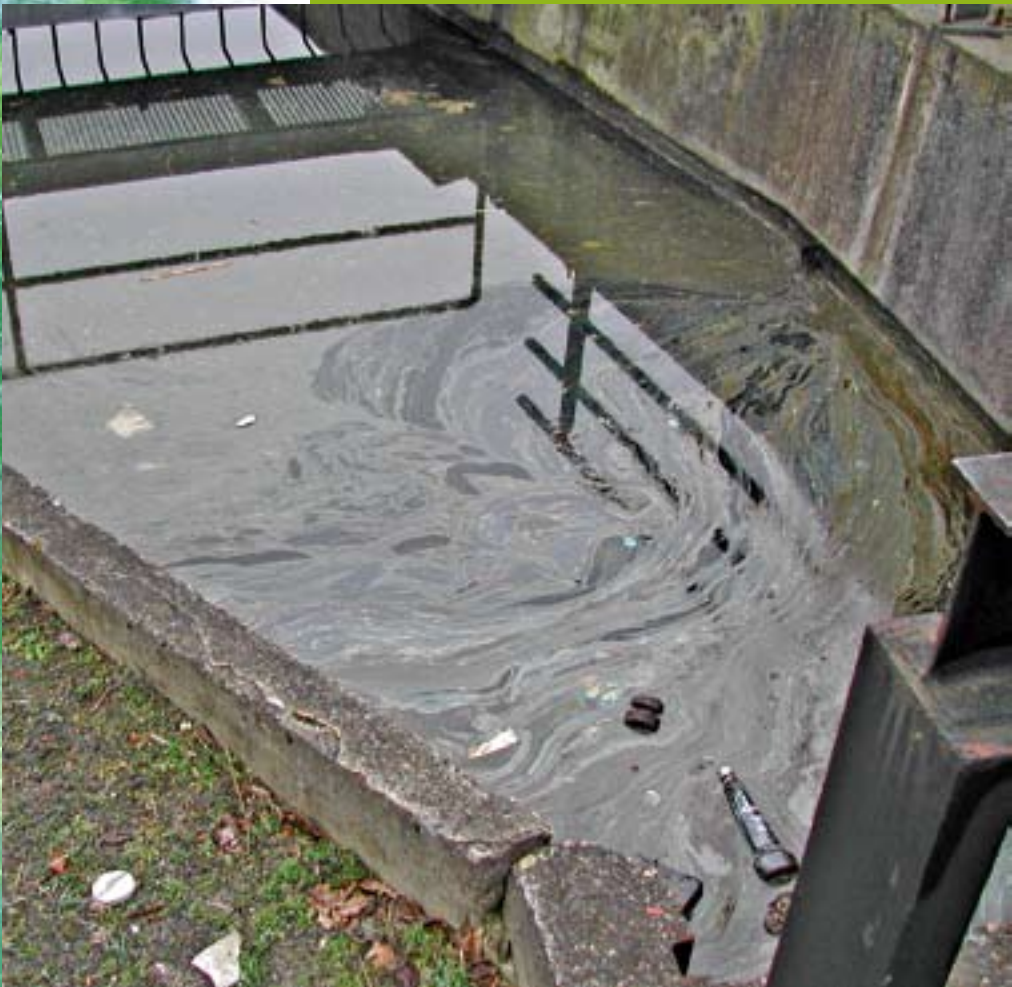
▲ Illegale olielozing en storten van afval vormen een directe bedreiging voor de waterkwaliteit.
