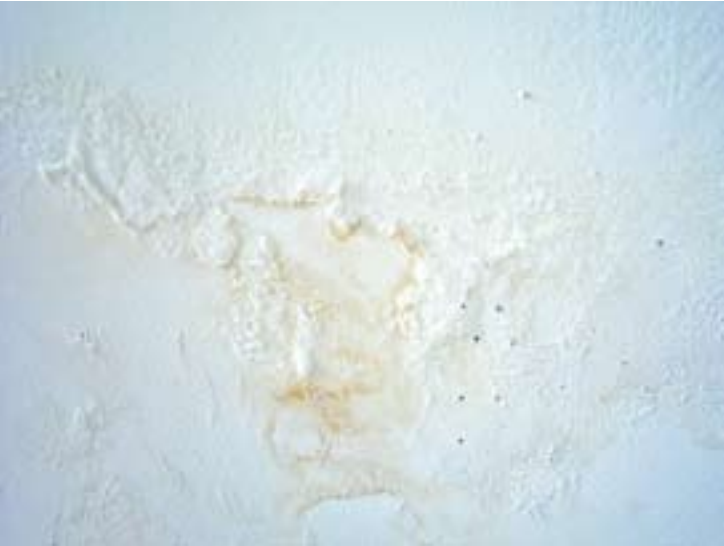
Hoge grondwaterstanden kunnen leiden tot vochtproblemen in de woning.
